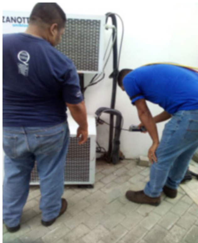
Mantenimientos de cuartos fríos
